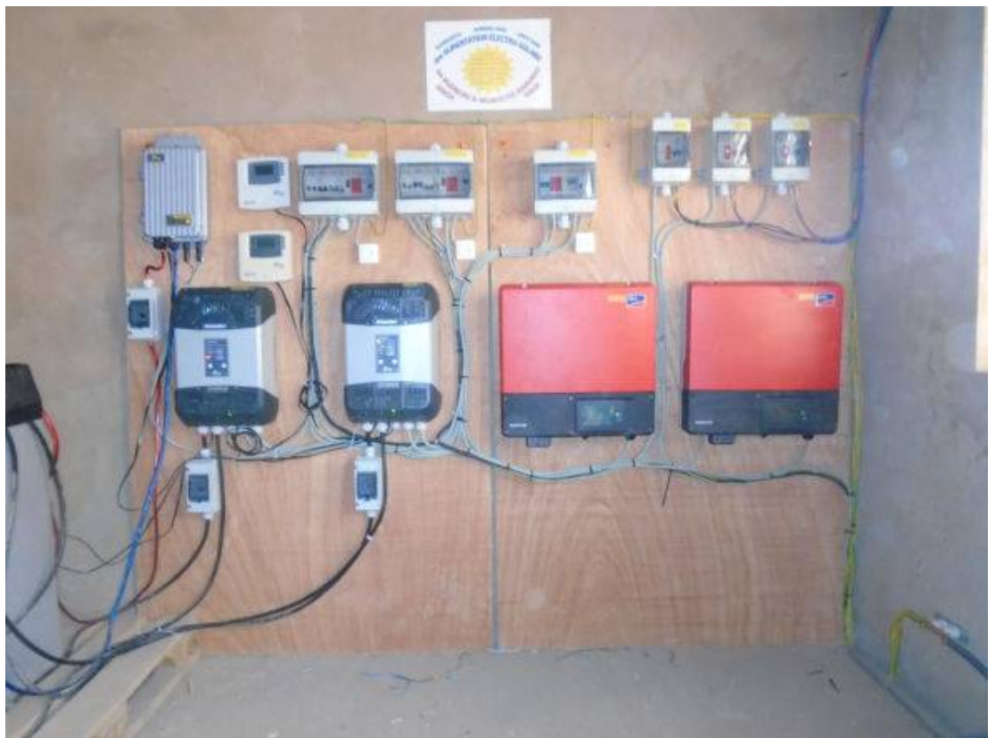
Les composants de la centrale, à côté du bloc de 24 batteries de 2V / 2'300Ah : En bas à gauche, les deux onduleurs chargeurs hybrides Studier de 4kVA, à droite les deux onduleurs de branche de SMA de 3,6kVA. En dessus, le chargeur MPPT de Studier de 3,6kVA et les boîtiers de commande d'Electronique solaire.
