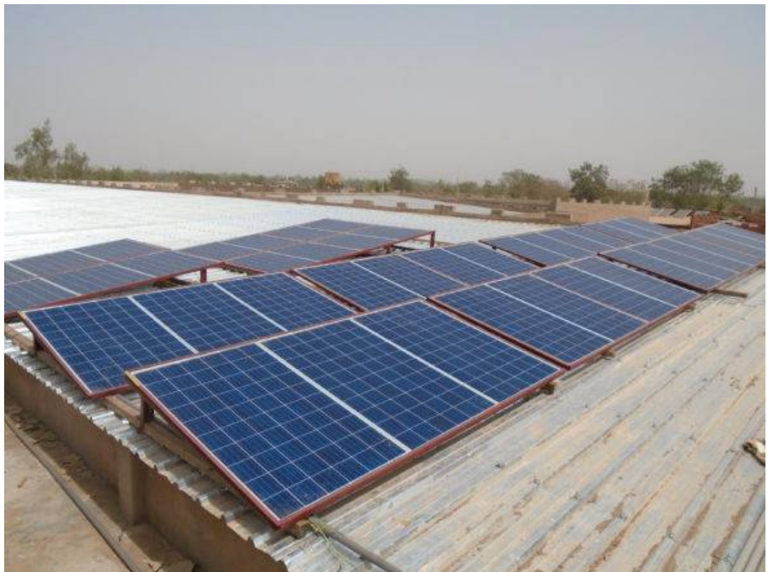
Enfin, les 3 champs de 14 panneaux photovoltaïques sont fixés sur le toit de la maternité : Orientation sud-est optimale pour le matin et sud-ouest optimale pour l'après-midi.
